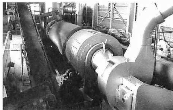
図2 山形ウッドエネルギーのペレット製造施設
