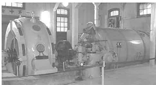
写真 3. 水車および発電機外観
