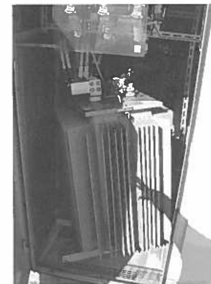
写真 1-1. 変圧器のずれ
