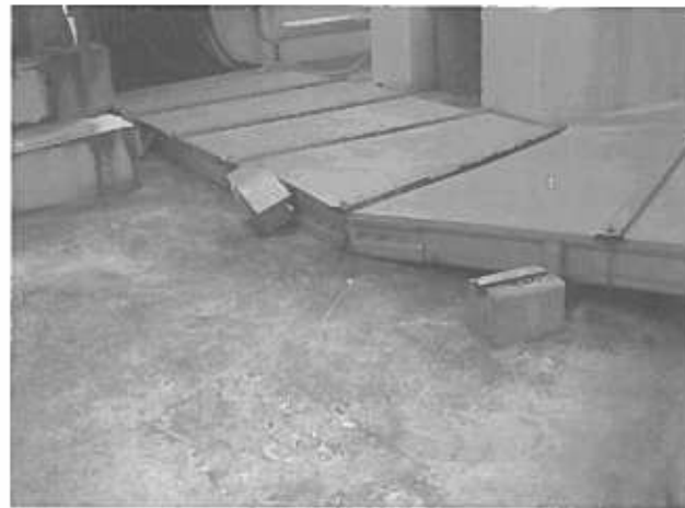
写真 5. ケーブルラック支持架台ブロックずれ
