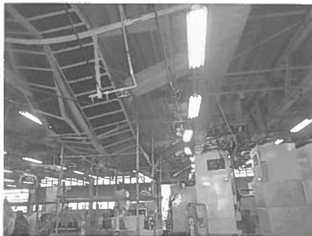
写真 3. ケーブルラックが捻じれ破損
