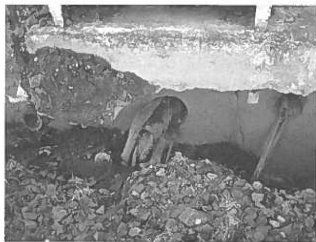
写真11. 地中埋設配管破断
