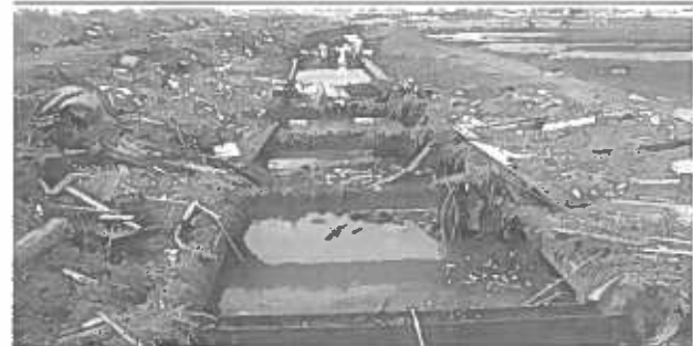
写真 2. 境堀幹線排水路被災状況
