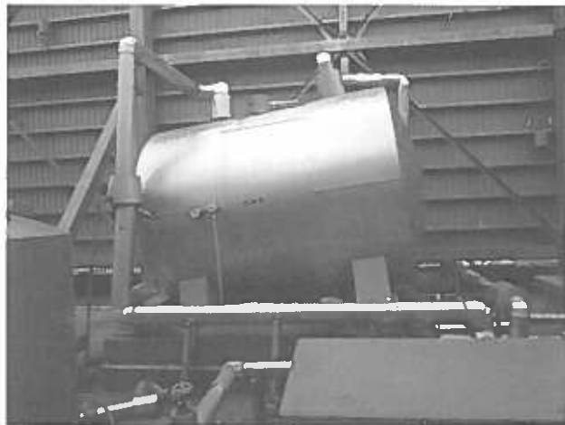
写真 3. 横型貯湯槽脚部の座屈による傾斜 4)
