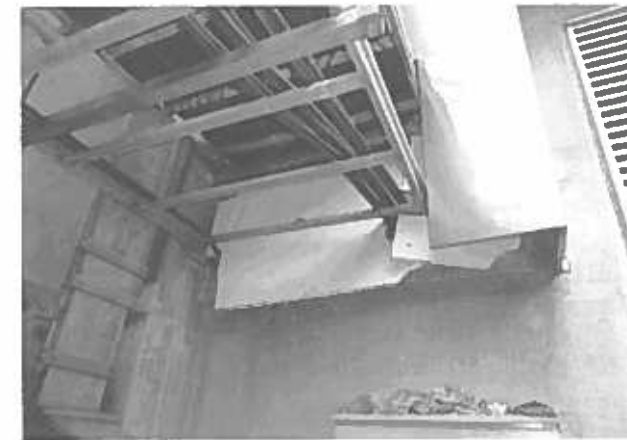
写真 6. 防火区画処理ボードの破損
