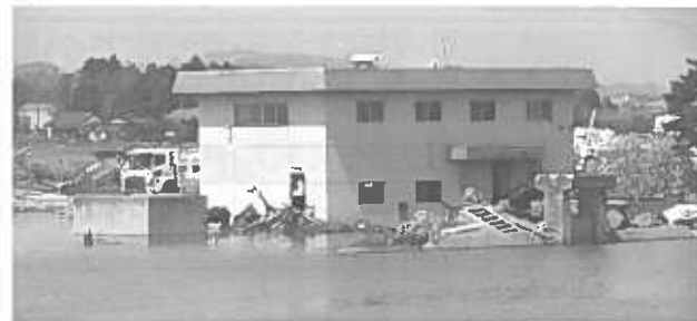
写真 4. 大曲排水機場被災状況(冠水)
