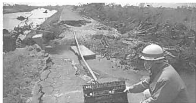
写真 3. 高瀬幹線排水路被災状況
