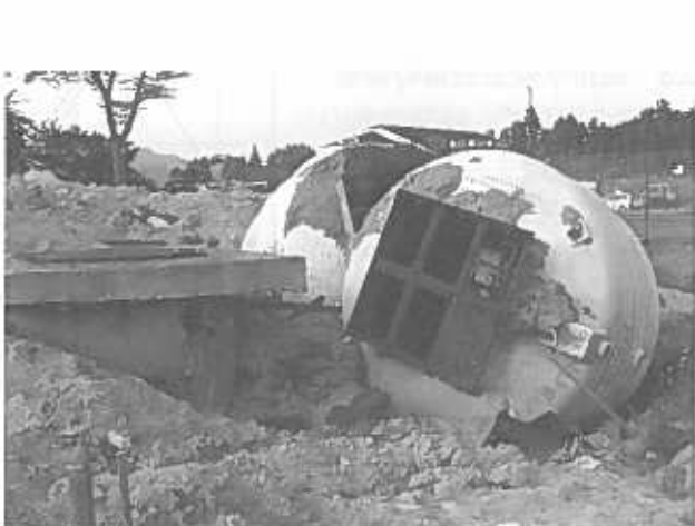
写真 4. 法面崩壊による沈殿槽の浮上転倒 4)
