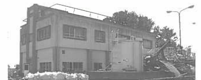
写真1. 閉上排水機場被災状況
