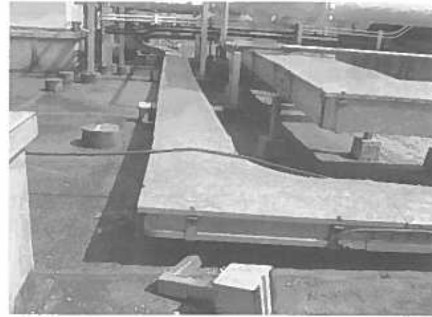
写真 4. ケーブルラック落下
