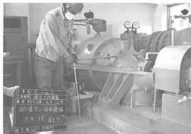
写真 5. 柳ノ目第二排水機場被災状況
