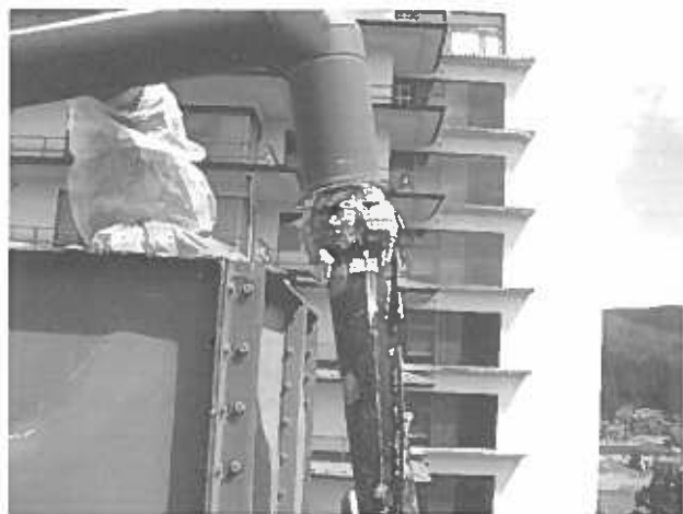
写真 1. 高置水槽周辺の揚水管継手部の破損 4)
