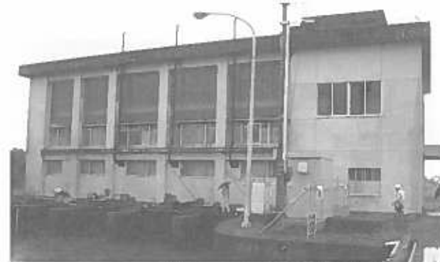
写真2. 相野釜排水機場の被災状況
