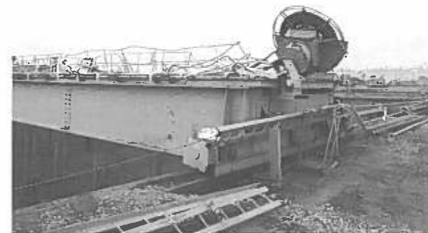
写真 4. 津波で破壊された最終沈殿池
