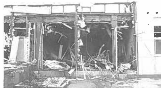
写真 5. 津波で被災した塩素滅菌室
