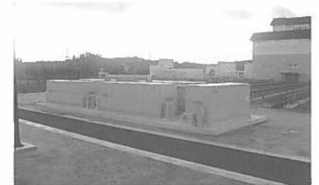
写真3. 仙台太陽光発電所 PCS等の連系設備外観
