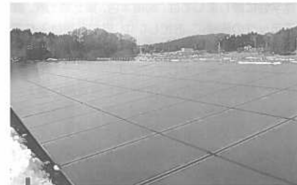
写真1. くじらのメガソーラー発電所外観
