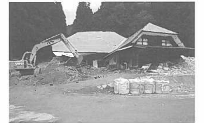
写真 1. 宮ノ前沢の土石流災害状況
