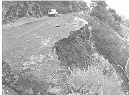
写真 2. 北部海岸部を走る国道の斜面崩落
