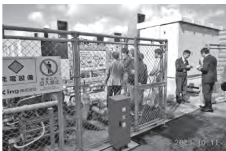
写真4. 鶴岡浄化センター
