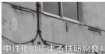
写真4. 中性化による鉄筋腐食事例(当日資料より)
